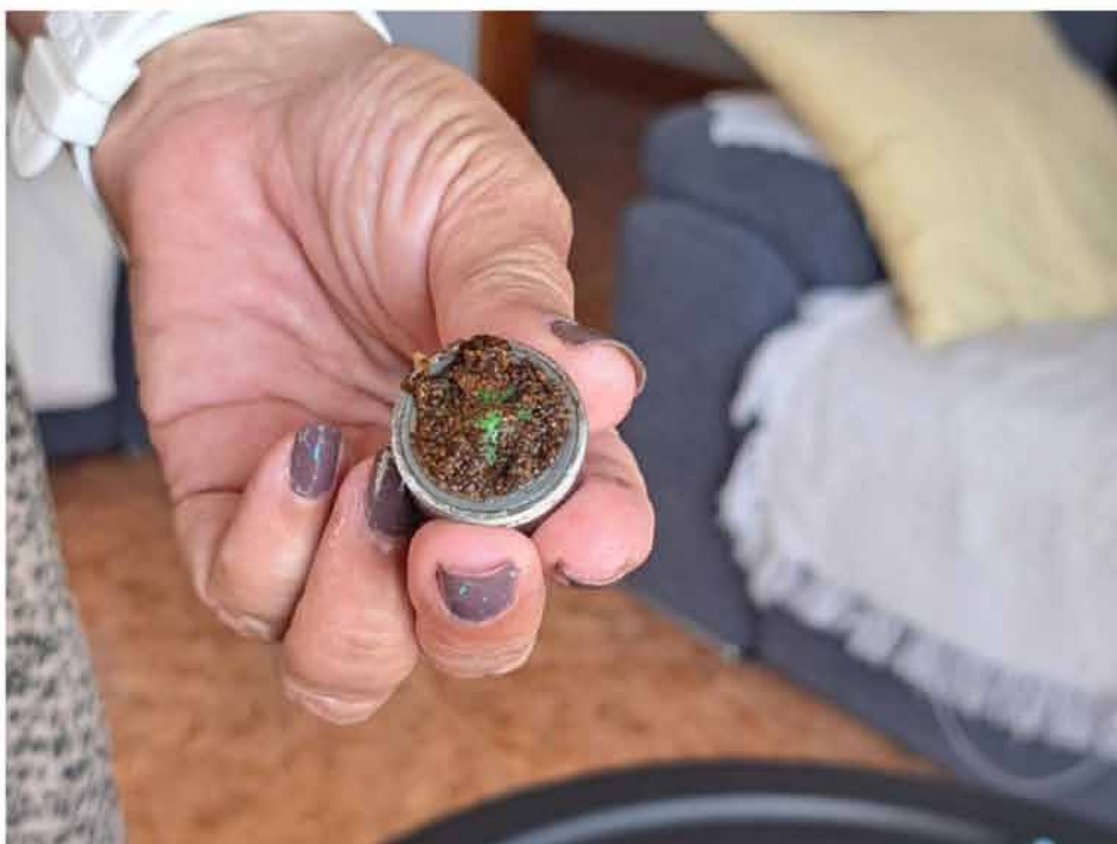
Defendiendo Los Abrigos Asociación de Vecinos Filtro de agua lleno de residuos
