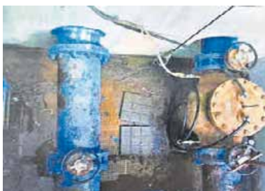
Válvulas y tuberías en mal estado. | Santos Álvarez
